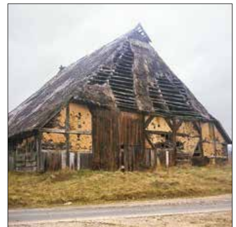
Die Durchfahrtscheune am Ursprungsort 1972. Die Gefache sind überwiegend mit Lehmflechtwerk ausgefüllt und stark geschädigt. Die unteren Gefache sind mit Bohlen geschlossen, das deutet auf eine Nutzung als Tierstall hin
