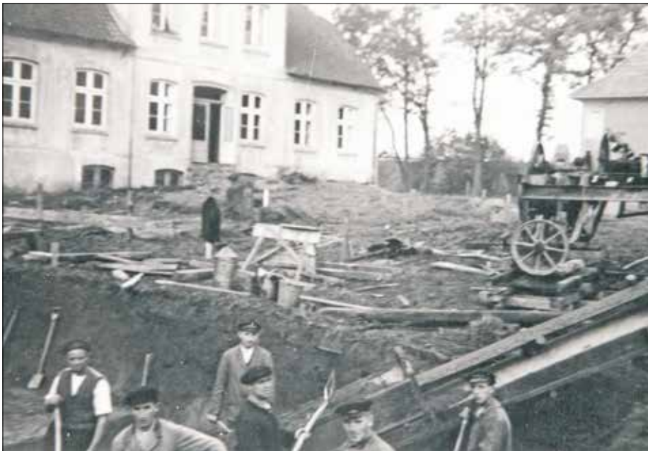
Vor der Günnemann-Villa wird der Keller für das Geschäftshaus Claus Ferck-Straße 5-7 (Schuh Kay) ausgeschachtet. Rechts im Hintergrund sieht man das Geschäftshaus Claus-Ferck-Straße 9-11 (Arnoldi, La Plaza, Hoffmeister)
